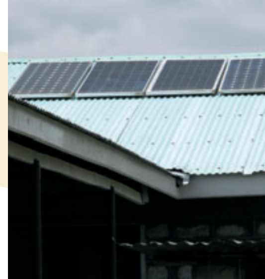
Sonnenkollektoren in Endulen Hospital, errichtet Ende 2009
